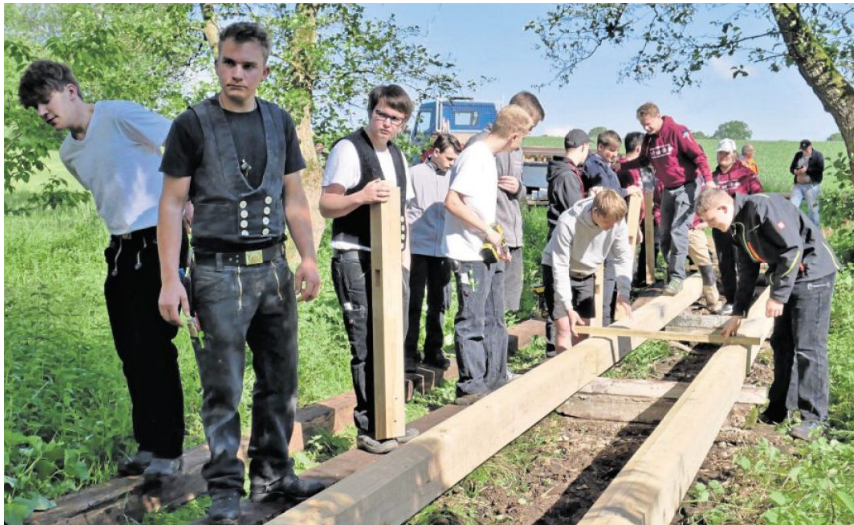
Das ist Praxiseinsatz statt Schulbank. 38 angehende Schreiner und Zimmerer fertigen einen Steg und eine Brücke am Kohlberger Naturerlebnisweg.
