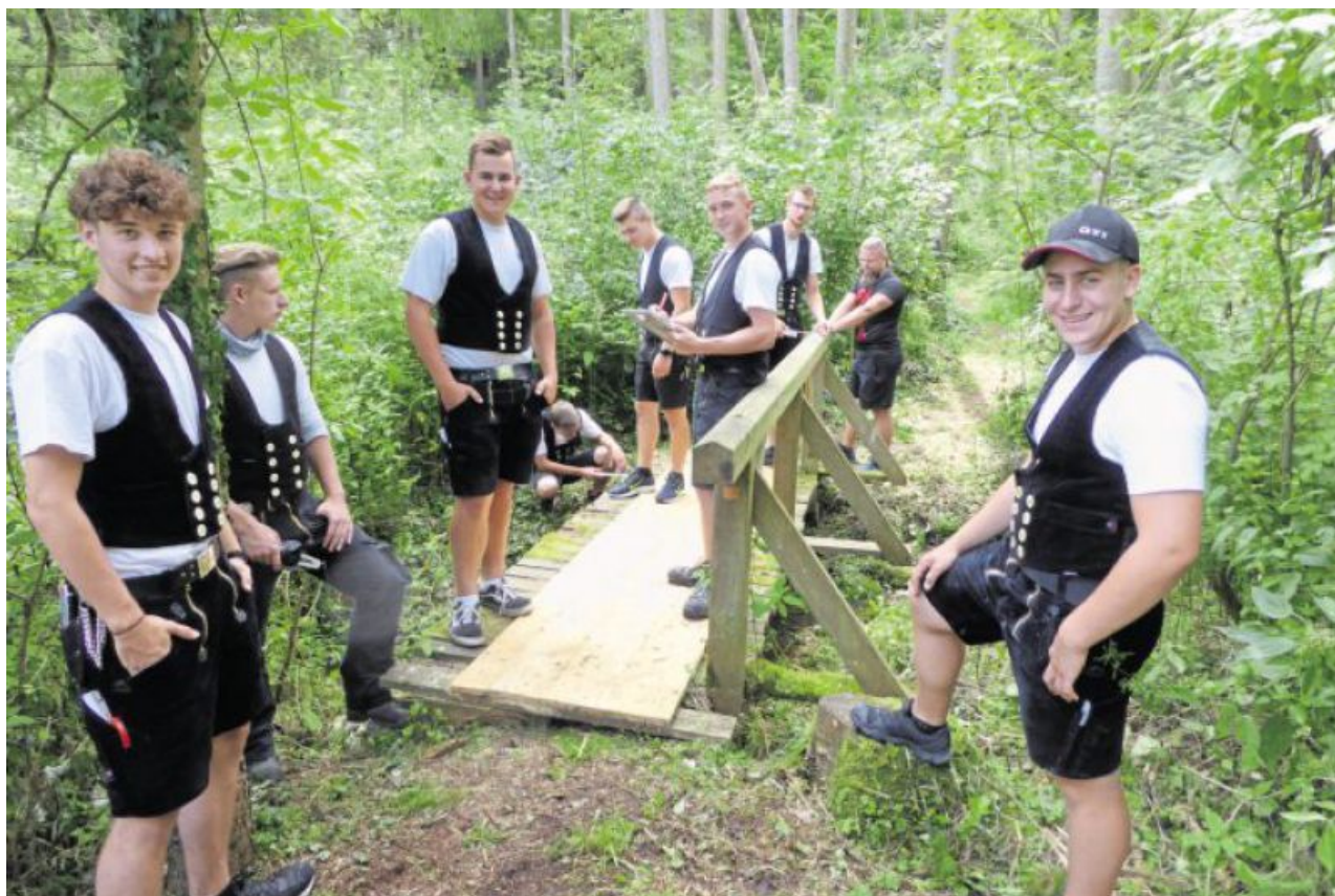
Auch diese kleine Holzbrücke über den Klingebach soll erneuert werden.
